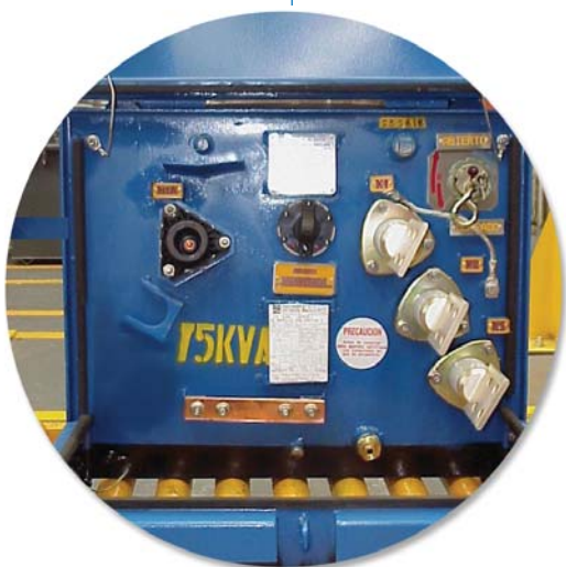
Operación radial (1 boquilla A.T.)
